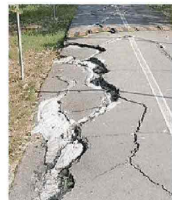
Gli avvallamenti sull'asfalto
